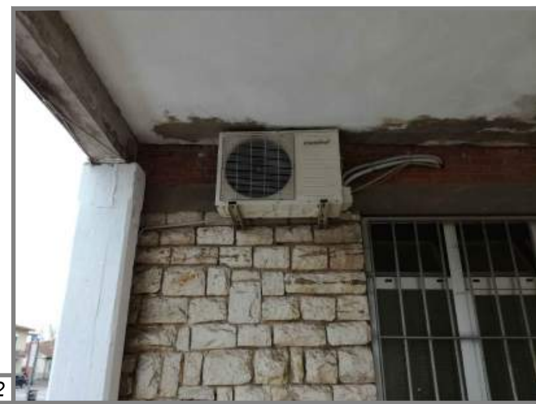
2 Scatla climatizzatore da rimuovere
