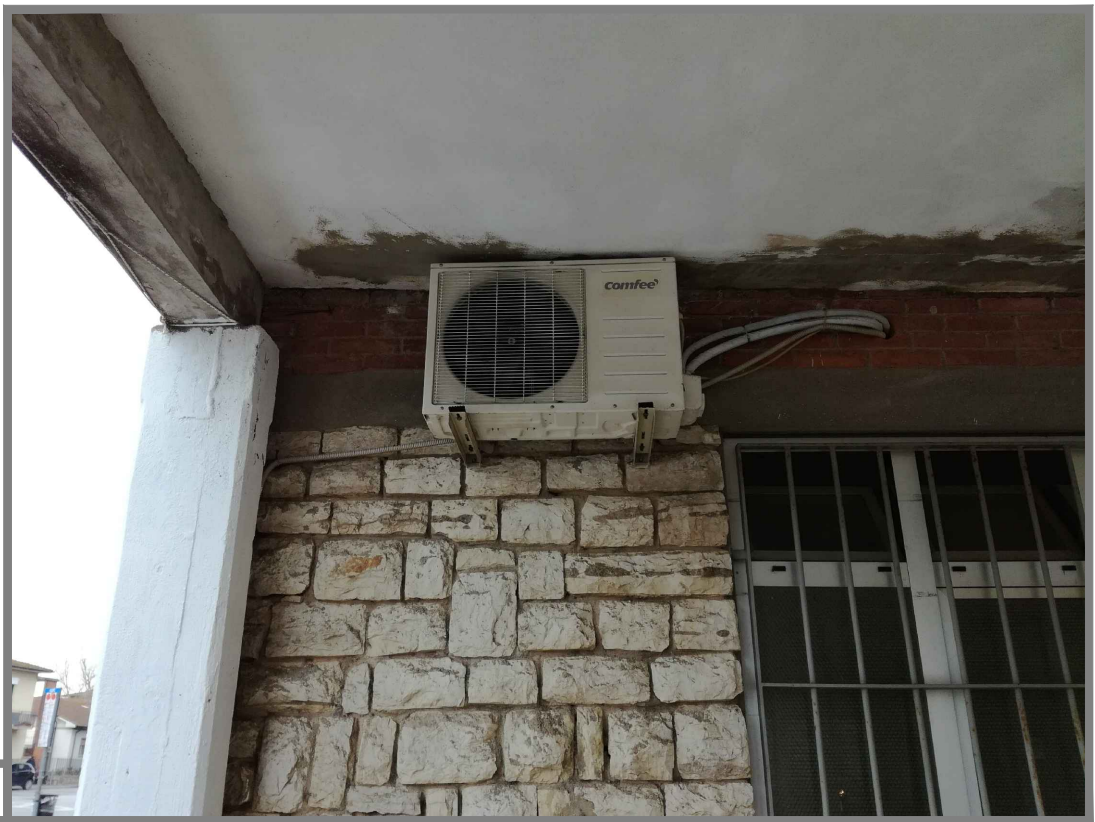
Scatla climatizzatore da rimuovere
