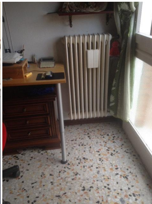
Figura 1.2- Radiatore a parete
